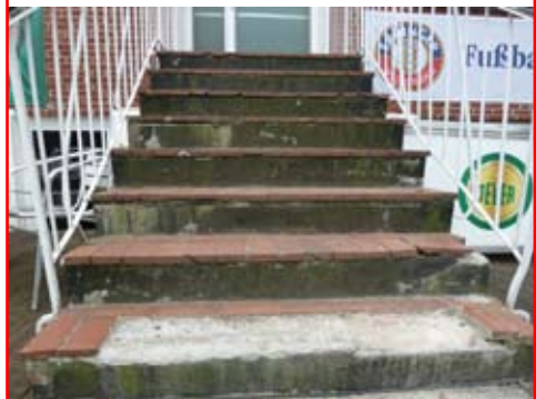
Ist-Zustand der Treppenstufen zum Clubhaus an der Griegstraße
